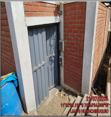
Pozo a tierra
