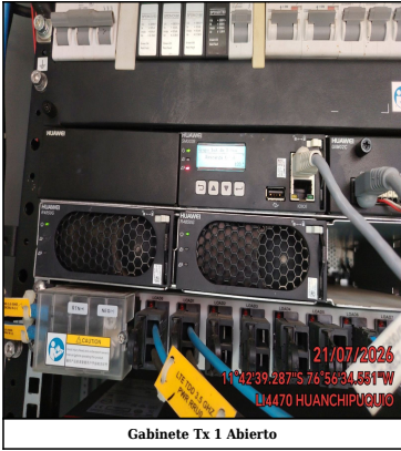
Gabinete Tx 1 Abierto
