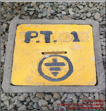
Pozo a tierra
