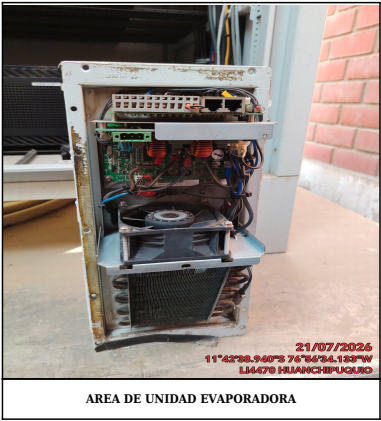
AREA DE UNIDAD EVAPORADORA
