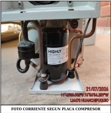
FOTO CORRIENTE SEGUN PLACA COMPRESOR
