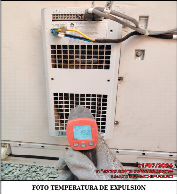
FOTO TEMPERATURA DE EXPULSION
