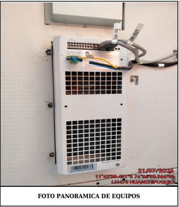
FOTO PANORAMICA DE EQUIPOS
