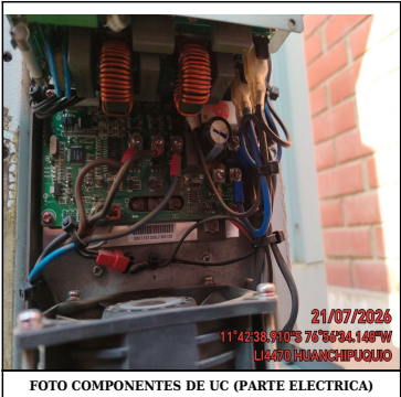
FOTO COMPONENTES DE UC (PARTE ELECTRICA)
