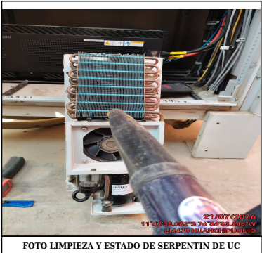
FOTO LIMPIEZA Y ESTADO DE SERPENTIN DE UC
