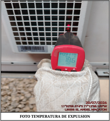
FOTO TEMPERATURA DE EXPULSION
