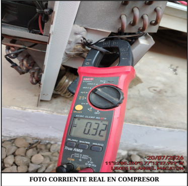
FOTO CORRIENTE REAL EN COMPRESOR
