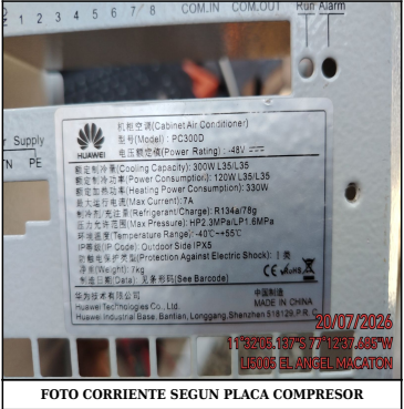
FOTO CORRIENTE SEGUN PLACA COMPRESOR
