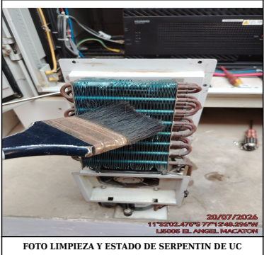
FOTO LIMPIEZA Y ESTADO DE SERPENTIN DE UC
