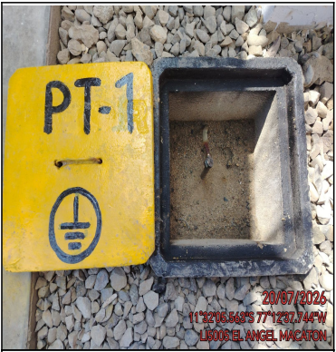
Pozo a tierra
