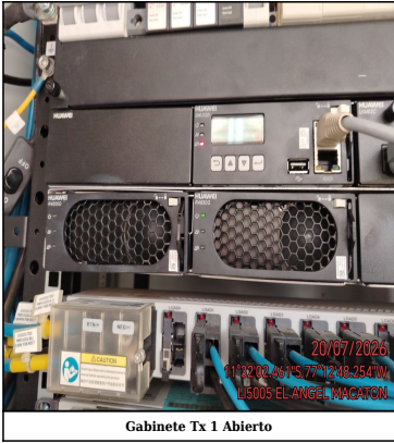
Gabinete Tx 1 Abierto
