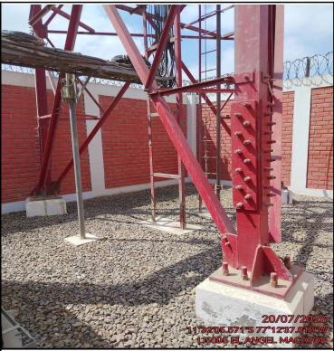
Foto Panorámica del Interior del Site
