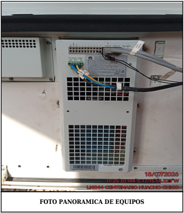
FOTO PANORAMICA DE EQUIPOS
