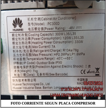
FOTO CORRIENTE SEGUN PLACA COMPRESOR
