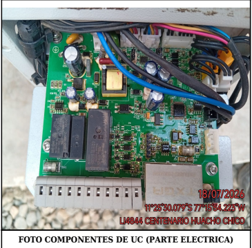
FOTO COMPONENTES DE UC (PARTE ELECTRICA)
