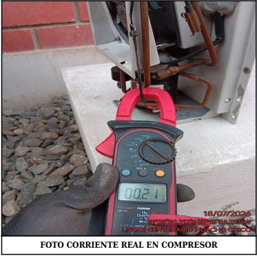
FOTO CORRIENTE REAL EN COMPRESOR
