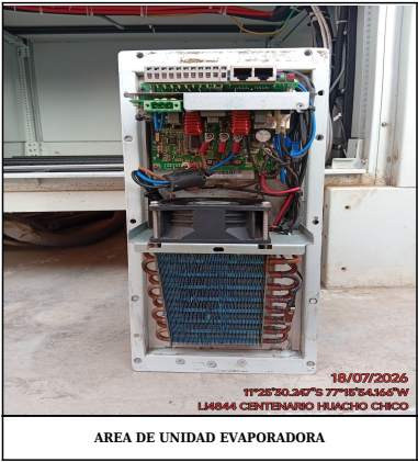
AREA DE UNIDAD EVAPORADORA
