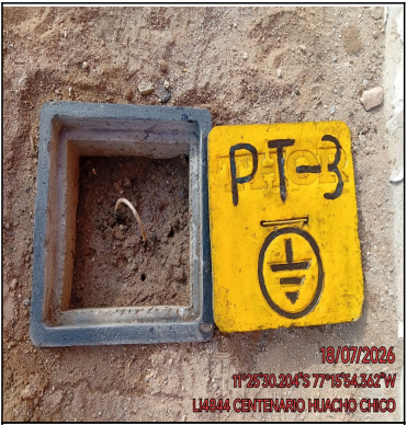
Pozo a tierra
