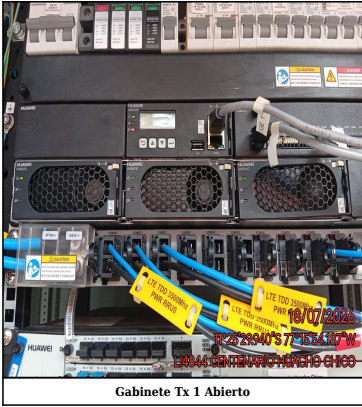
Gabinete Tx 1 Abierto
