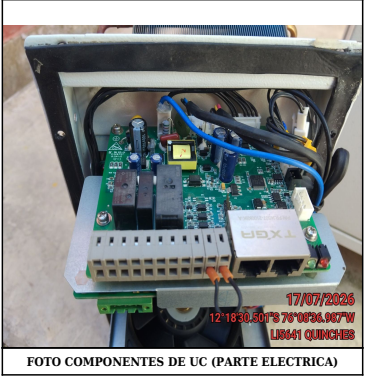
FOTO COMPONENTES DE UC (PARTE ELECTRICA)
