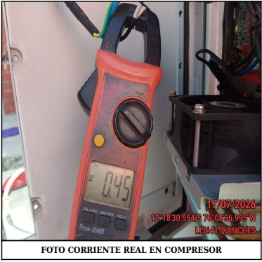
FOTO CORRIENTE REAL EN COMPRESOR
