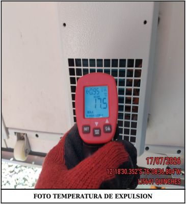
FOTO TEMPERATURA DE EXPULSION
