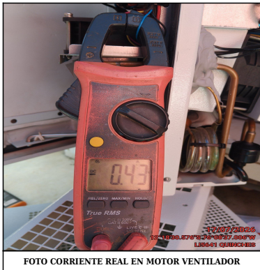
FOTO CORRIENTE REAL EN MOTOR VENTILADOR
