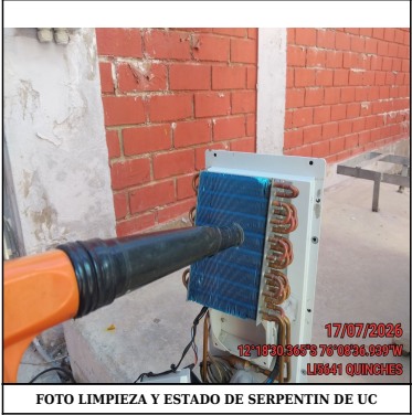
FOTO LIMPIEZA Y ESTADO DE SERPENTIN DE UC
