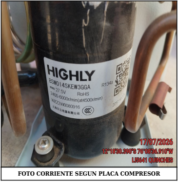
FOTO CORRIENTE SEGUN PLACA COMPRESOR
