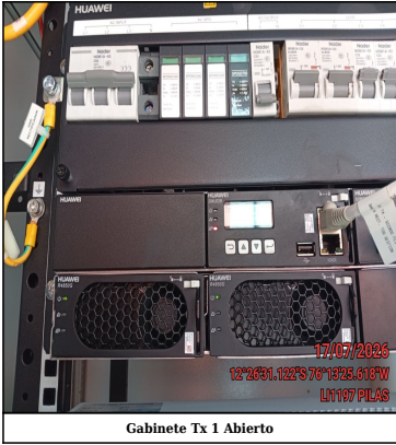
Gabinete Tx 1 Abierto
