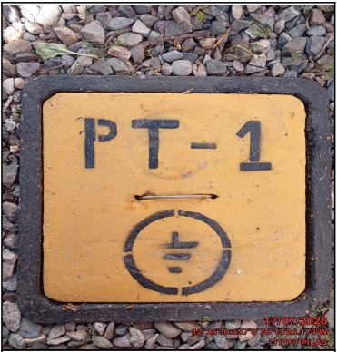
Pozo a tierra
