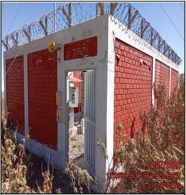
Pozo a tierra
