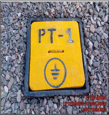
Pozo a tierra
