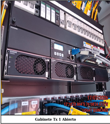
Gabinete Tx 1 Abierto
