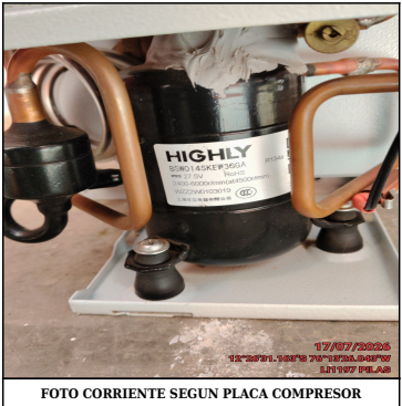
FOTO CORRIENTE SEGUN PLACA COMPRESOR
