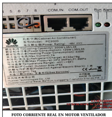
FOTO CORRIENTE REAL EN MOTOR VENTILADOR
