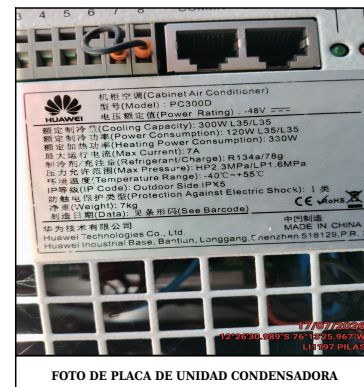
FOTO DE PLACA DE UNIDAD CONDENSADORA
