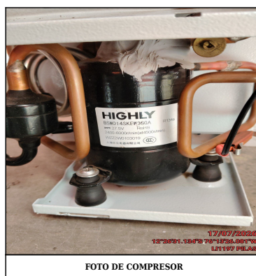
FOTO DE COMPRESOR
