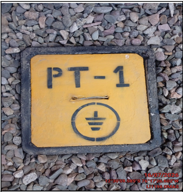
Pozo a tierra
