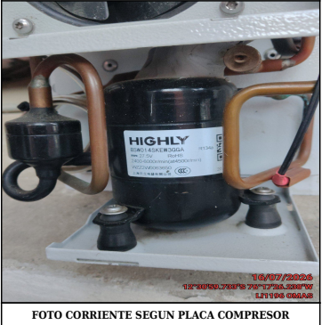
FOTO CORRIENTE SEGUN PLACA COMPRESOR
