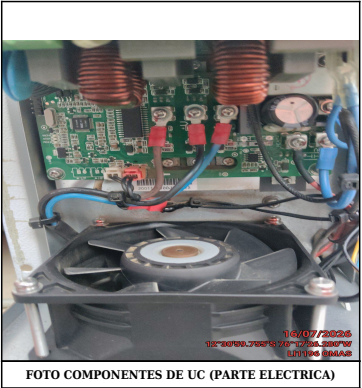
FOTO COMPONENTES DE UC (PARTE ELECTRICA)
