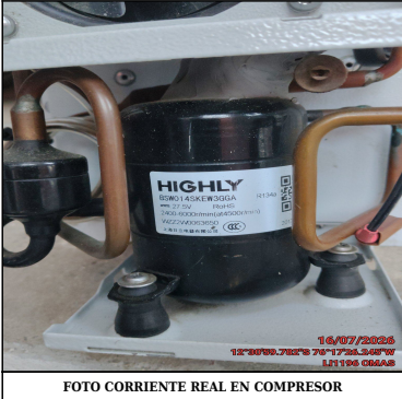
FOTO CORRIENTE REAL EN COMPRESOR
