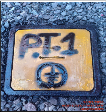
Pozo a tierra
