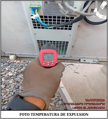
FOTO TEMPERATURA DE EXPULSION
