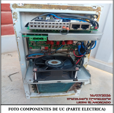
FOTO COMPONENTES DE UC (PARTE ELECTRICA)
