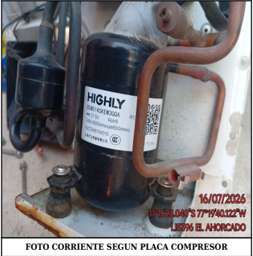
FOTO CORRIENTE SEGUN PLACA COMPRESOR
