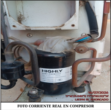
FOTO CORRIENTE REAL EN COMPRESOR
