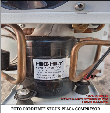
FOTO CORRIENTE SEGUN PLACA COMPRESOR
