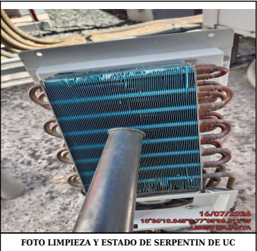
FOTO LIMPIEZA Y ESTADO DE SERPENTIN DE UC
