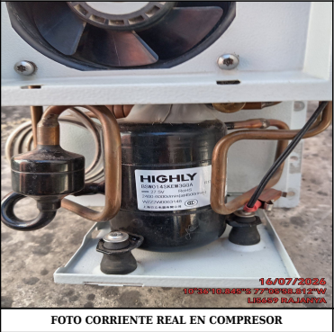
FOTO CORRIENTE REAL EN COMPRESOR
