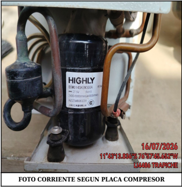
FOTO CORRIENTE SEGUN PLACA COMPRESOR
