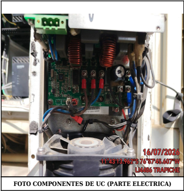
FOTO COMPONENTES DE UC (PARTE ELECTRICA)
