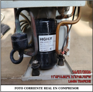
FOTO CORRIENTE REAL EN COMPRESOR
