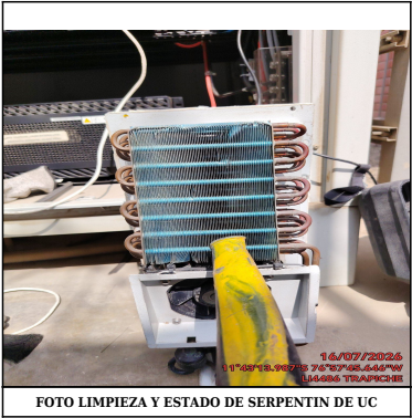
FOTO LIMPIEZA Y ESTADO DE SERPENTIN DE UC
