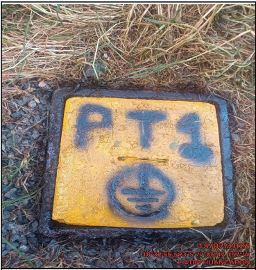
Pozo a tierra
