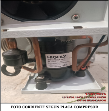
FOTO CORRIENTE SEGUN PLACA COMPRESOR
