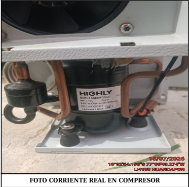
FOTO CORRIENTE REAL EN COMPRESOR
