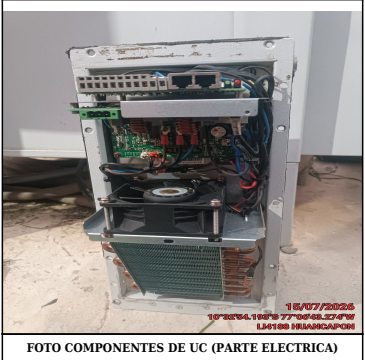
FOTO COMPONENTES DE UC (PARTE ELECTRICA)
