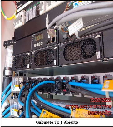
Gabinete Tx 1 Abierto
