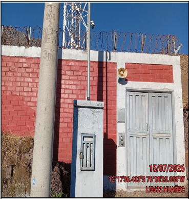
Pozo a tierra
