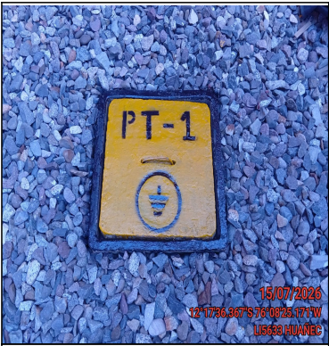
Pozo a tierra
