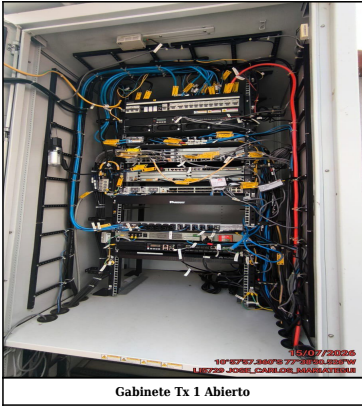
Gabinete Tx 1 Abierto
