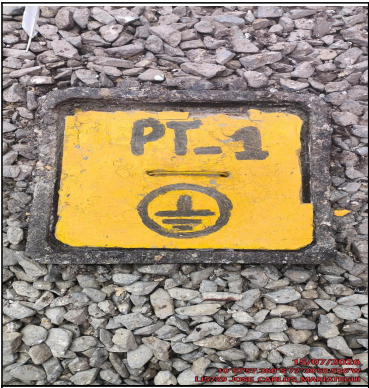
Pozo a tierra
