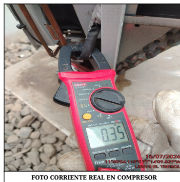
FOTO CORRIENTE REAL EN COMPRESOR
