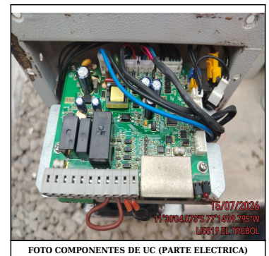
FOTO COMPONENTES DE UC (PARTE ELECTRICA)
