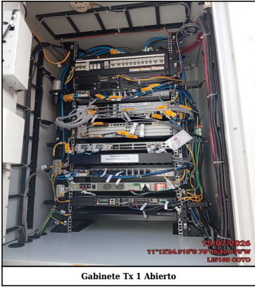
Gabinete Tx 1 Abierto
