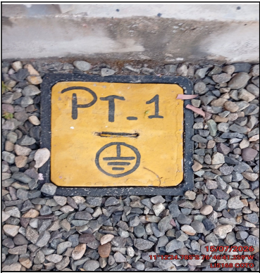
Pozo a tierra
