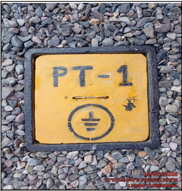
Pozo a tierra
