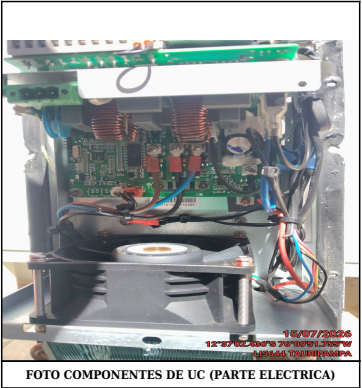
FOTO COMPONENTES DE UC (PARTE ELECTRICA)
