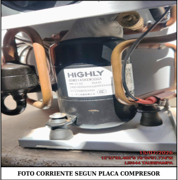
FOTO CORRIENTE SEGUN PLACA COMPRESOR
