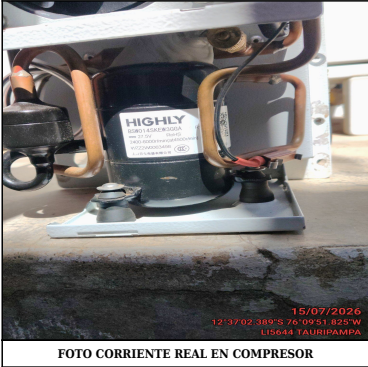
FOTO CORRIENTE REAL EN COMPRESOR
