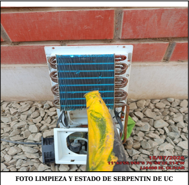
FOTO LIMPIEZA Y ESTADO DE SERPENTIN DE UC
