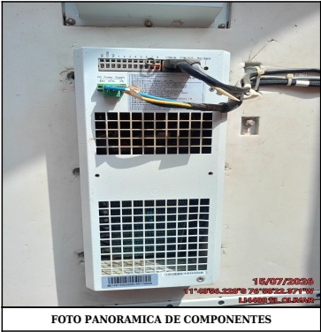
FOTO PANORAMICA DE COMPONENTES
