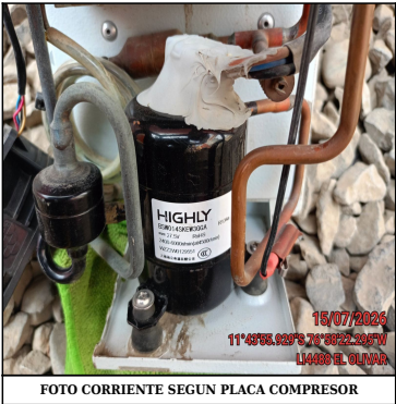
FOTO CORRIENTE SEGUN PLACA COMPRESOR
