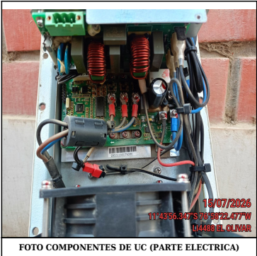
FOTO COMPONENTES DE UC (PARTE ELECTRICA)
