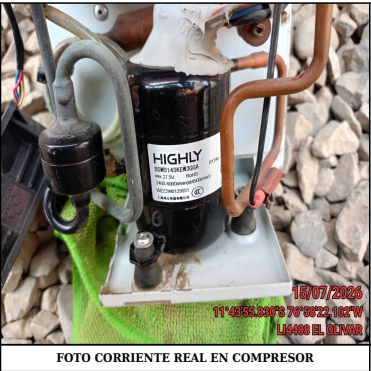
FOTO CORRIENTE REAL EN COMPRESOR
