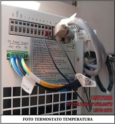
FOTO TERMOSTATO TEMPERATURA
