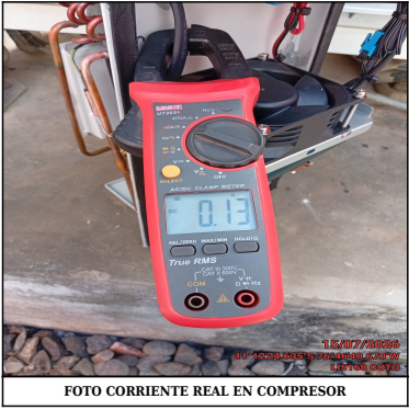
FOTO CORRIENTE REAL EN COMPRESOR
