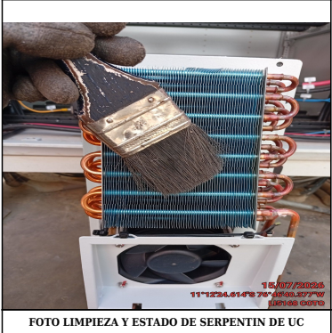
FOTO LIMPIEZA Y ESTADO DE SERPENTIN DE UC
