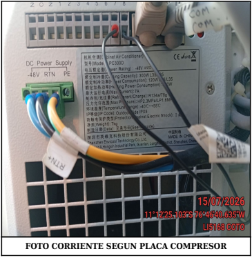
FOTO CORRIENTE SEGUN PLACA COMPRESOR
