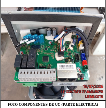
FOTO COMPONENTES DE UC (PARTE ELECTRICA)
