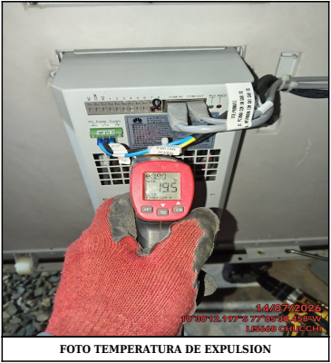
FOTO TEMPERATURA DE EXPULSION
