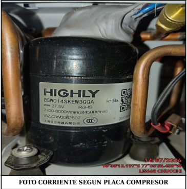
FOTO CORRIENTE SEGUN PLACA COMPRESOR
