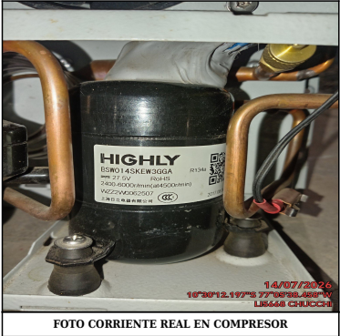
FOTO CORRIENTE REAL EN COMPRESOR
