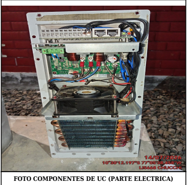
FOTO COMPONENTES DE UC (PARTE ELECTRICA)
