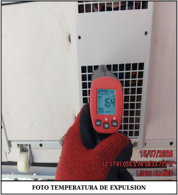
FOTO TEMPERATURA DE EXPULSION
