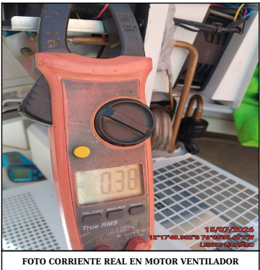
FOTO CORRIENTE REAL EN MOTOR VENTILADOR
