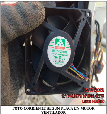
FOTO CORRIENTE SEGUN PLACA EN MOTOR VENTILADOR
