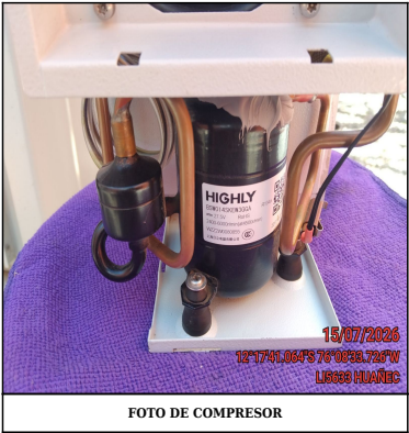
FOTO DE COMPRESOR
