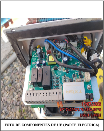
FOTO DE COMPONENTES DE UE (PARTE ELECTRICA)
