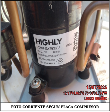
FOTO CORRIENTE SEGUN PLACA COMPRESOR
