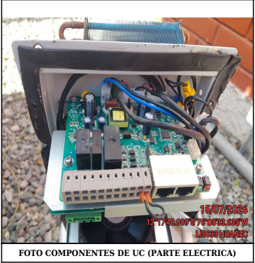
FOTO COMPONENTES DE UC (PARTE ELECTRICA)
