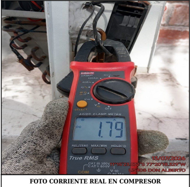
FOTO CORRIENTE REAL EN COMPRESOR
