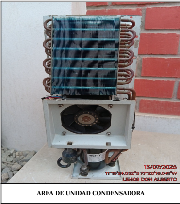
AREA DE UNIDAD CONDENSADORA
