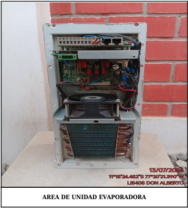
AREA DE UNIDAD EVAPORADORA
