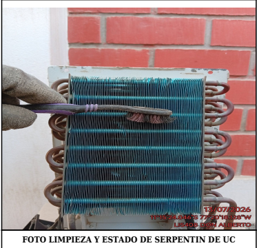
FOTO LIMPIEZA Y ESTADO DE SERPENTIN DE UC
