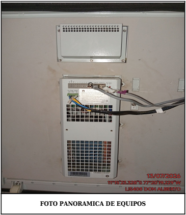
FOTO PANORAMICA DE EQUIPOS
