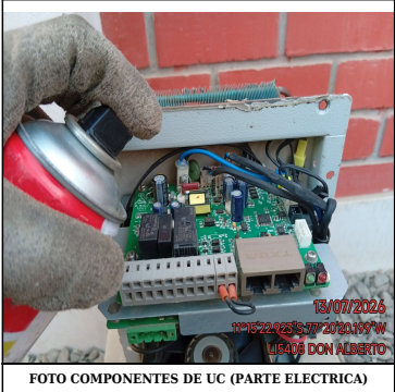
FOTO COMPONENTES DE UC (PARTE ELECTRICA)
