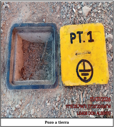
Pozo a tierra
