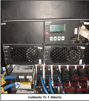
Gabinete Tx 1 Abierto
