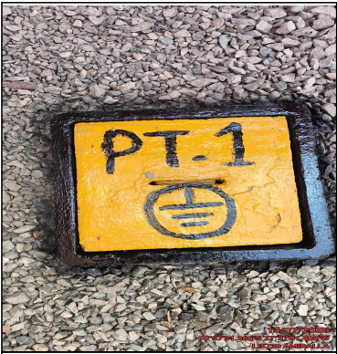
Pozo a tierra
