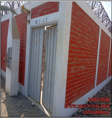
Pozo a tierra
