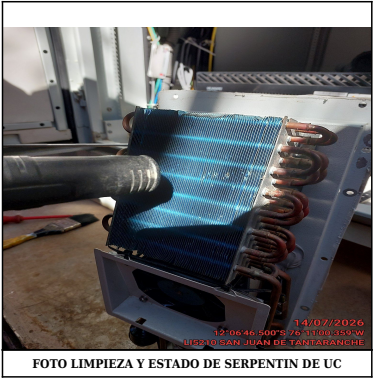
FOTO LIMPIEZA Y ESTADO DE SERPENTIN DE UC
