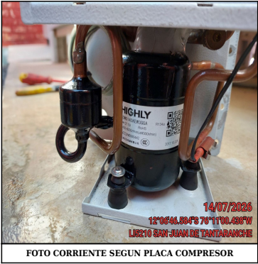
FOTO CORRIENTE SEGUN PLACA COMPRESOR
