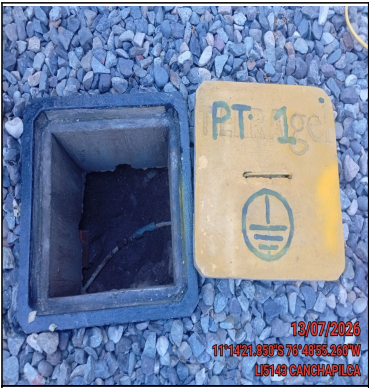
Pozo a tierra
