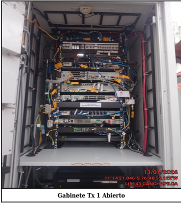
Gabinete Tx 1 Abierto
