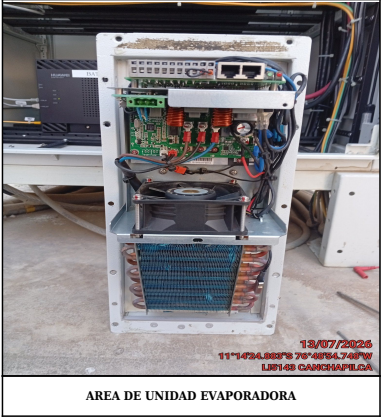
AREA DE UNIDAD EVAPORADORA
