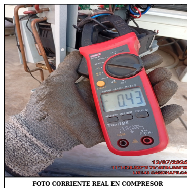
FOTO CORRIENTE REAL EN COMPRESOR
