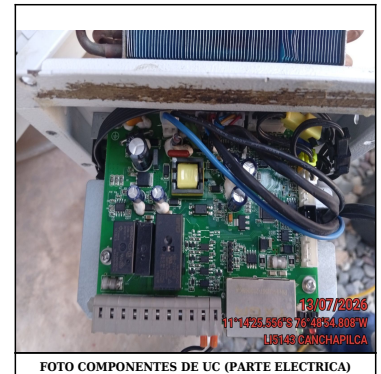
FOTO COMPONENTES DE UC (PARTE ELECTRICA)
