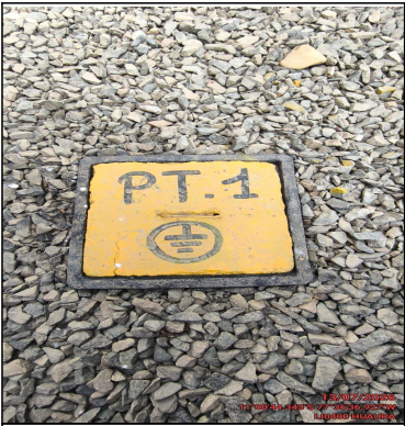
Pozo a tierra
