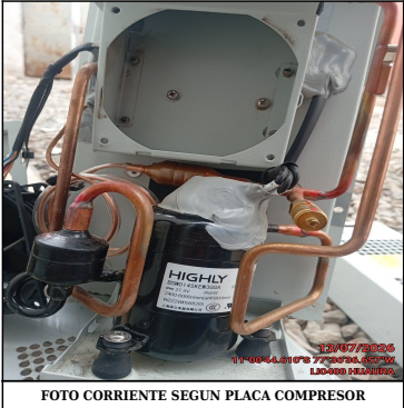
FOTO CORRIENTE SEGUN PLACA COMPRESOR
