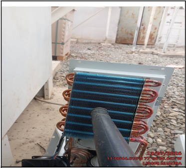
FOTO LIMPIEZA Y ESTADO DE SERPENTIN DE UC
