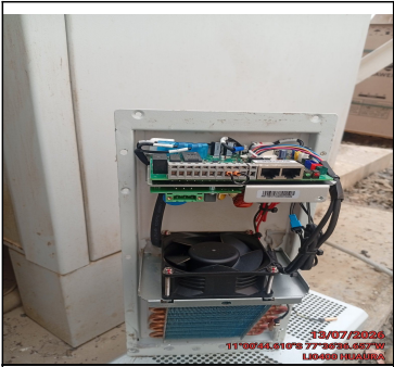
FOTO COMPONENTES DE UC (PARTE ELECTRICA)
