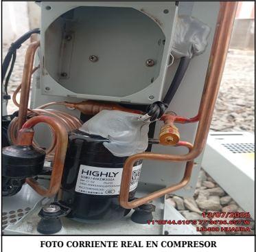
FOTO CORRIENTE REAL EN COMPRESOR
