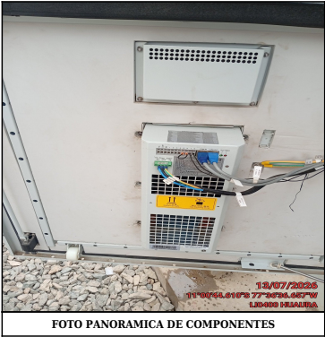
FOTO PANORAMICA DE COMPONENTES
