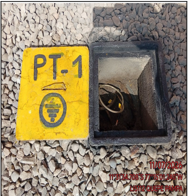
Pozo a tierra
