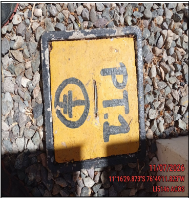
Pozo a tierra
