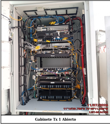
Gabinete Tx 1 Abierto
