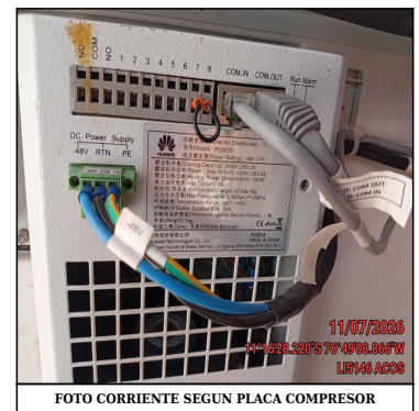
FOTO CORRIENTE SEGUN PLACA COMPRESOR
