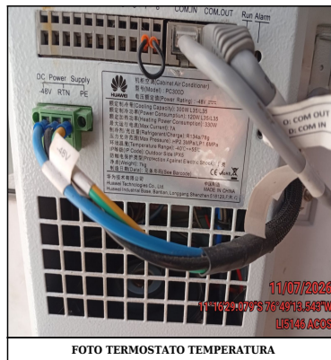
FOTO TERMOSTATO TEMPERATURA
