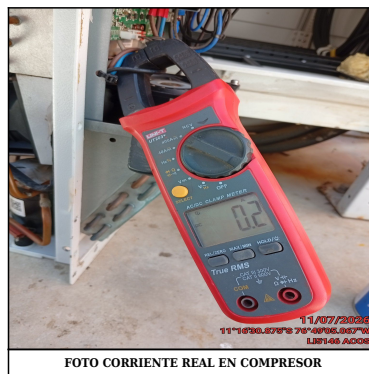
FOTO CORRIENTE REAL EN COMPRESOR
