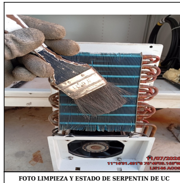
FOTO LIMPIEZA Y ESTADO DE SERPENTIN DE UC
