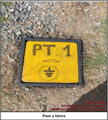
Pozo a tierra
