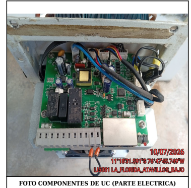
FOTO COMPONENTES DE UC (PARTE ELECTRICA)
