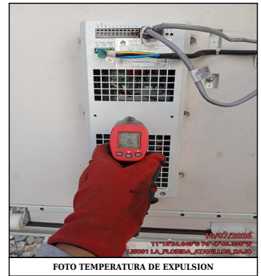
FOTO TEMPERATURA DE EXPULSION
