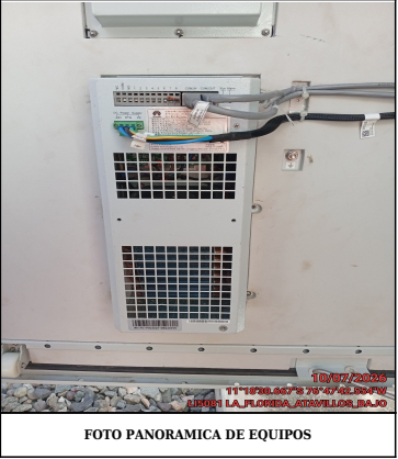
FOTO PANORAMICA DE EQUIPOS
