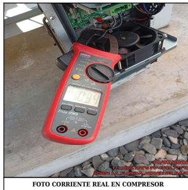
FOTO CORRIENTE REAL EN COMPRESOR
