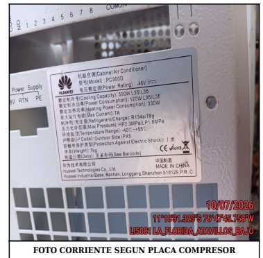
FOTO CORRIENTE SEGUN PLACA COMPRESOR
