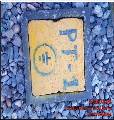
Pozo a tierra
