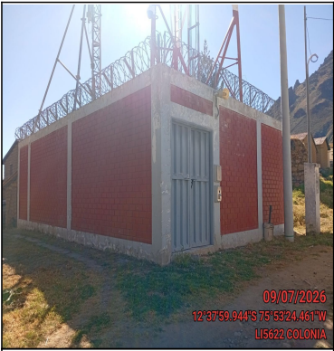
Pozo a tierra
