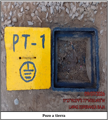
Pozo a tierra
