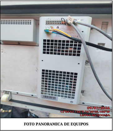
FOTO PANORAMICA DE EQUIPOS
