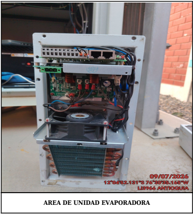
AREA DE UNIDAD EVAPORADORA
