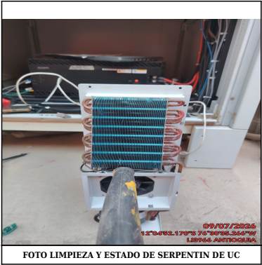
FOTO LIMPIEZA Y ESTADO DE SERPENTIN DE UC
