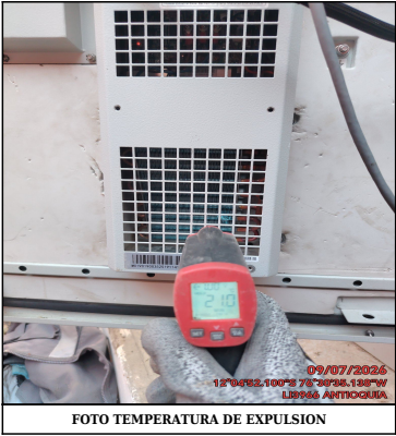
FOTO TEMPERATURA DE EXPULSION
