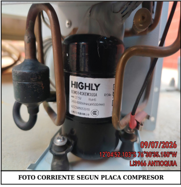
FOTO CORRIENTE SEGUN PLACA COMPRESOR
