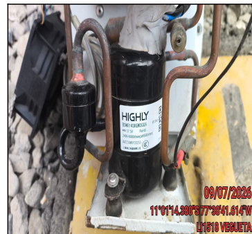
FOTO CORRIENTE SEGUN PLACA COMPRESOR
