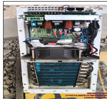
FOTO COMPONENTES DE UC (PARTE ELECTRICA)
