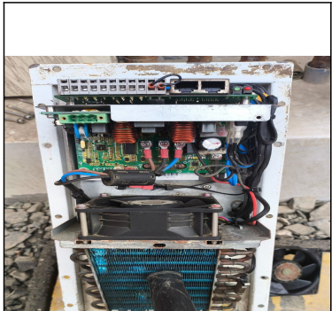
FOTO DE LIMPIEZA Y ESTADO DE SERPENTIN DE UE
