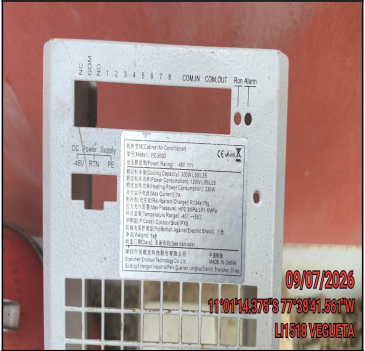
FOTO DE PLACA DE UNIDAD CONDENSADORA
