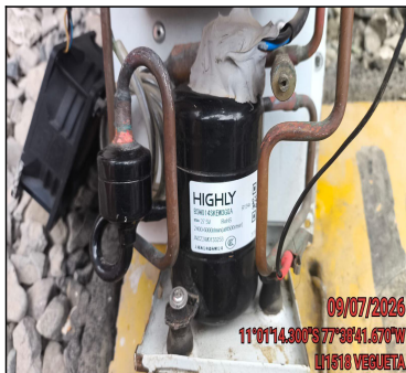
FOTO CORRIENTE REAL EN COMPRESOR
