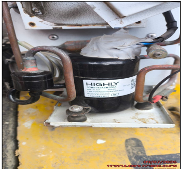
FOTO DE COMPRESOR
