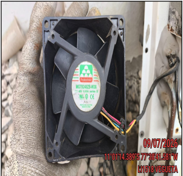
FOTO CORRIENTE SEGUN PLACA EN MOTOR VENTILADOR
