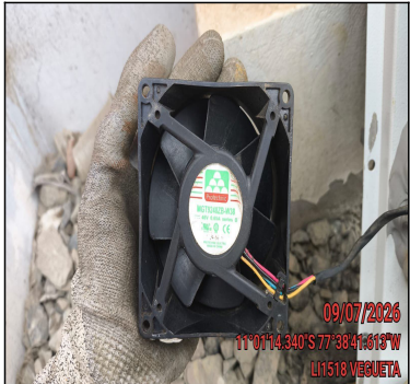
FOTO CORRIENTE REAL EN MOTOR VENTILADOR
