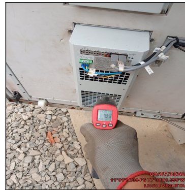
FOTO TEMPERATURA DE EXPULSION
