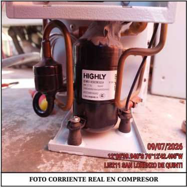
FOTO CORRIENTE REAL EN COMPRESOR
