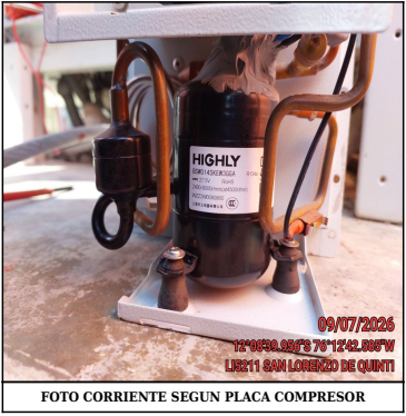
FOTO CORRIENTE SEGUN PLACA COMPRESOR
