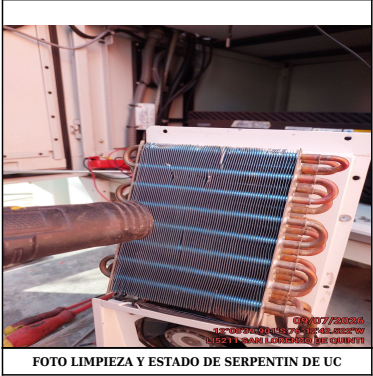
FOTO LIMPIEZA Y ESTADO DE SERPENTIN DE UC
