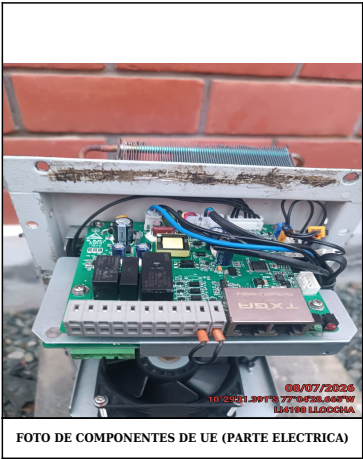
FOTO DE COMPONENTES DE UE (PARTE ELECTRICA)
