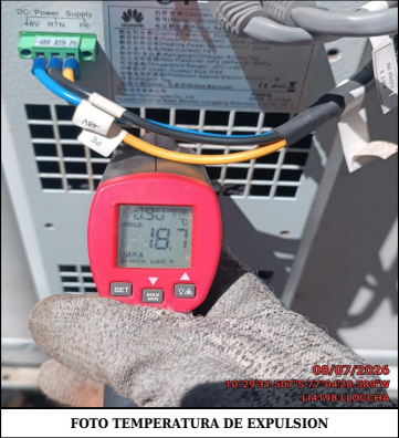
FOTO TEMPERATURA DE EXPULSION
