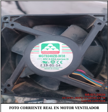
FOTO CORRIENTE REAL EN MOTOR VENTILADOR
