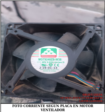
FOTO CORRIENTE SEGUN PLACA EN MOTOR VENTILADOR
