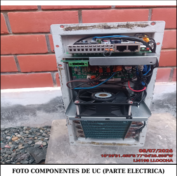
FOTO COMPONENTES DE UC (PARTE ELECTRICA)
