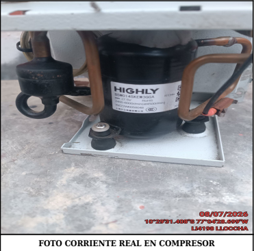
FOTO CORRIENTE REAL EN COMPRESOR
