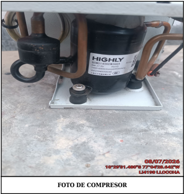
FOTO DE COMPRESOR
