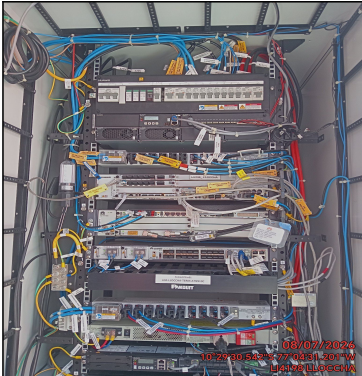
Gabinete Tx 1 Abierto
