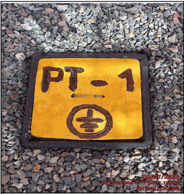
Pozo a tierra
