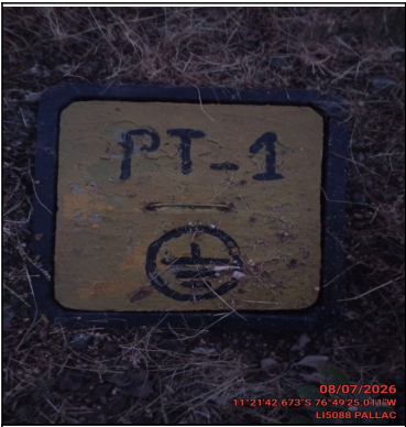
Pozo a tierra
