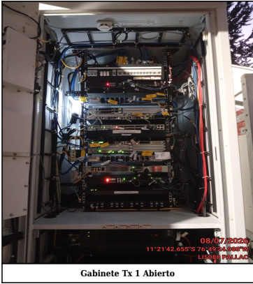
Gabinete Tx 1 Abierto
