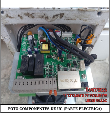
FOTO COMPONENTES DE UC (PARTE ELECTRICA)
