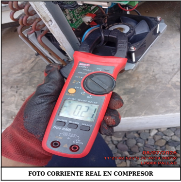
FOTO CORRIENTE REAL EN COMPRESOR
