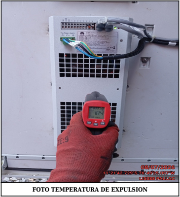
FOTO TEMPERATURA DE EXPULSION
