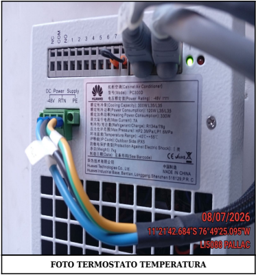
FOTO TERMOSTATO TEMPERATURA
