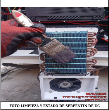
FOTO LIMPIEZA Y ESTADO DE SERPENTIN DE UC
